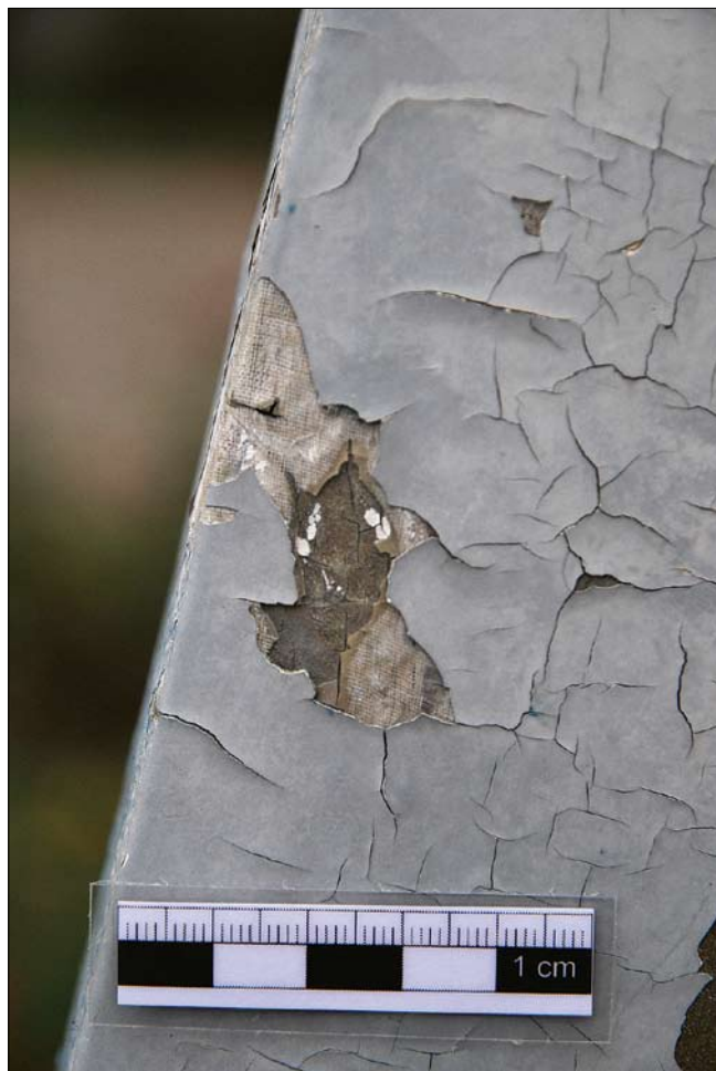
Obr. 6: Detail poškození – odpadlé krakely, snímek z roku 2015 (foto J. Červinka).
