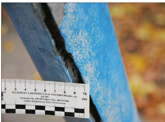
Obr. 8: Detail poškození – trhlina na noze sochy, snímek z roku 2015 (foto J. Červinka).
